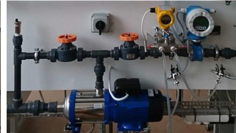
Rys. 2. Zbliżenie na elementy pomiarowe
